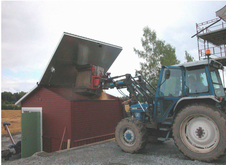
Fylling av flis på 150 kW anlegg i Stange (Fjetre gård)
