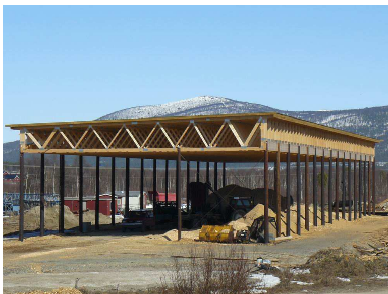
Flisterminal på Tynset (Ring Flis og Varme AS) 2007/2008
