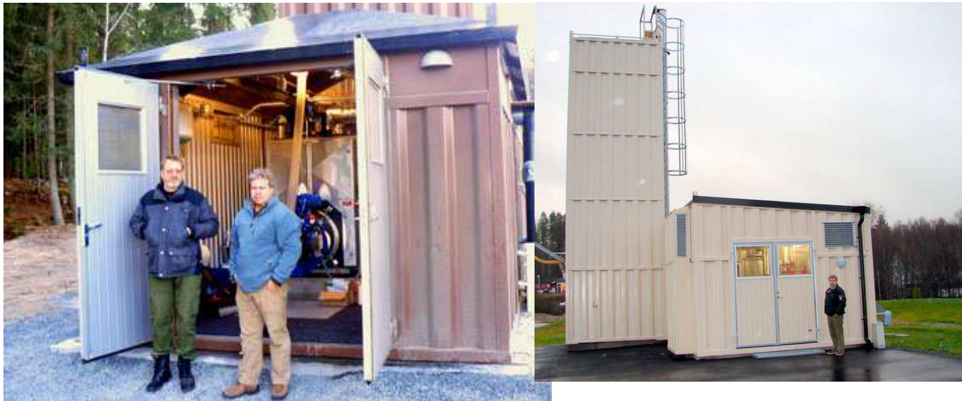
Pelletsfyrte anlegg i Nord-Odal hver med 0,4 MW pelletsbrenner (Odal Biovarme AS) (Til venstre 2007, til høyre 2003)
