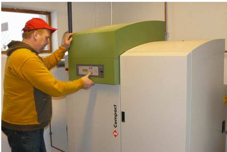
Anlegg 80 kW på Enger gård i Ringsaker (2008)
