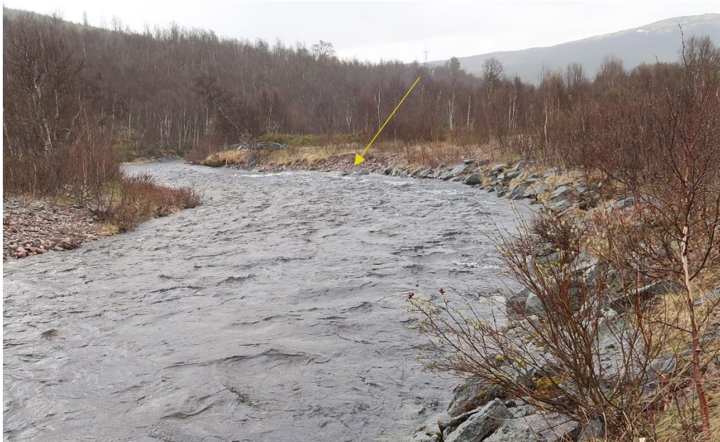
Figur 23. Sikring i elvesvingen, som skal hindre vann i å trenge inn i flomløpet. Gul pil markerer erosjon i flomvernet.
