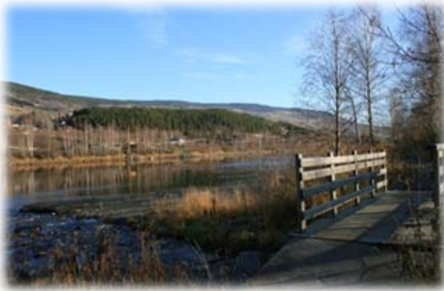
Gangbroa trenger vedlikehold i overgang rampe-bro
