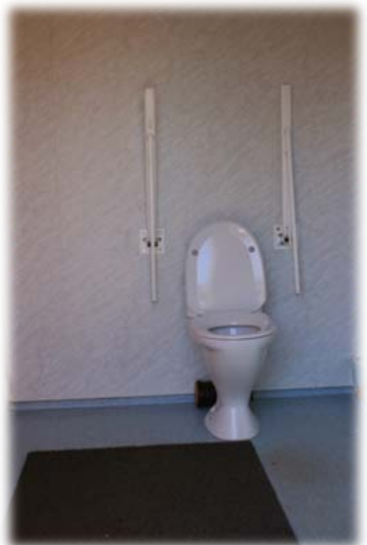
Alle krav til HC-toalett oppfylles inne, men umulig å komme inn!
