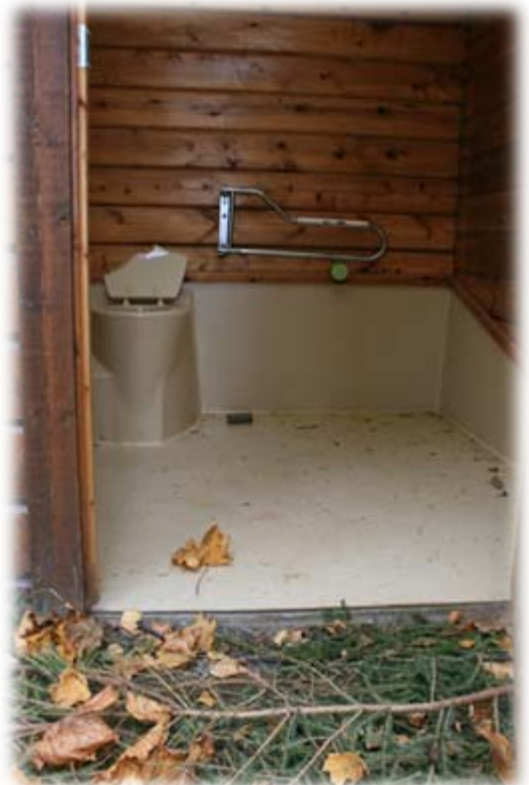
Løst underlag ved inngangsparti, + terskel på ca 5 cm
