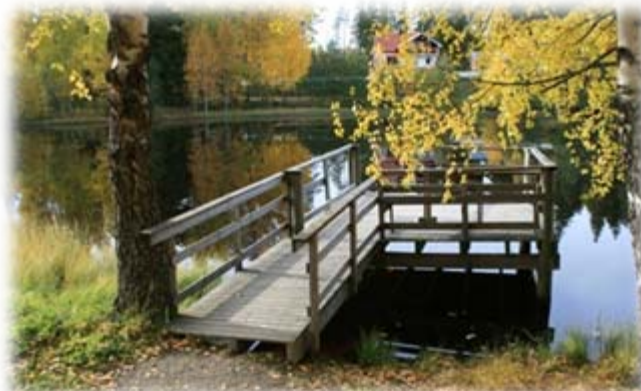
Fiskebrygga trenger fyllmasse, eller at det monteres en rampe opp
