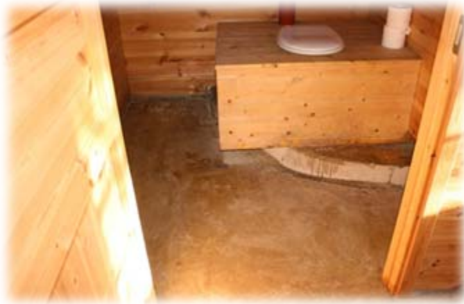
Støpt sementring på golvet gjør det trangt for rullestol!
