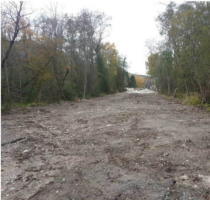
Figur 23. Linvikselva etter restaurering, høsten 2014. Foto: Alexandra Abrahamson.
