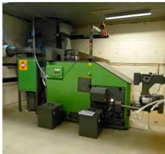
Flisfyringsanlegg. Foto: Eiliv Sandberg.
